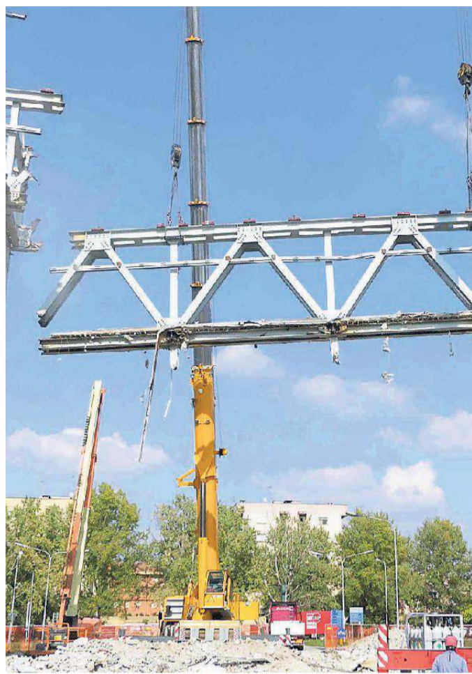
La travatura reticolata viene agganciata dalla gru che la depositerà a terra
